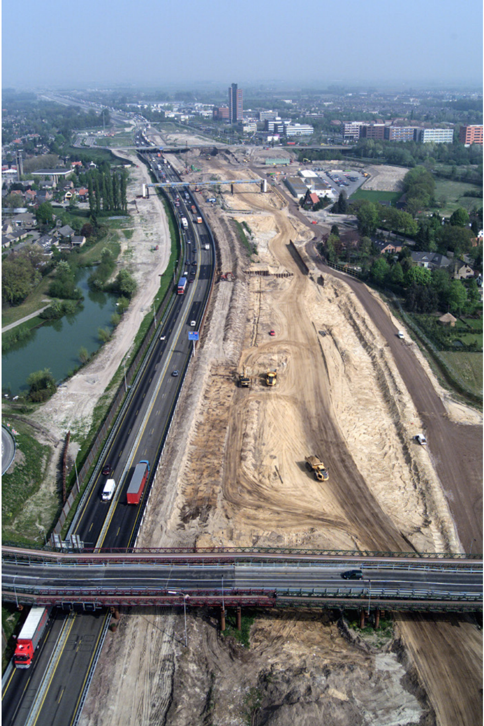
16. Werkzaamheden tijdens de verbreding en verschuiving van de A16 en de aanleg van de HSL-lijn (bron: Beeldcollectie, Rijkswaterstaat)
