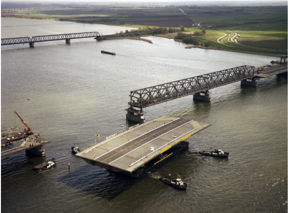
11. De oude bruggdelen van de Moerdijkbrug werden in 1977 één voor één vervangen door nieuwe. (bron: Beeldbank Rijkswaterstaat)
